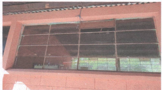
Foto 2: Se observa la necesidad de sustitución de ventana por balcones para mayor seguridad y ambiente (Modulos 1 y 2).
